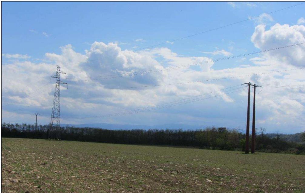
Illustration 31 : Pylônes électriques sur le site d'étude Source : Artifex 2023
